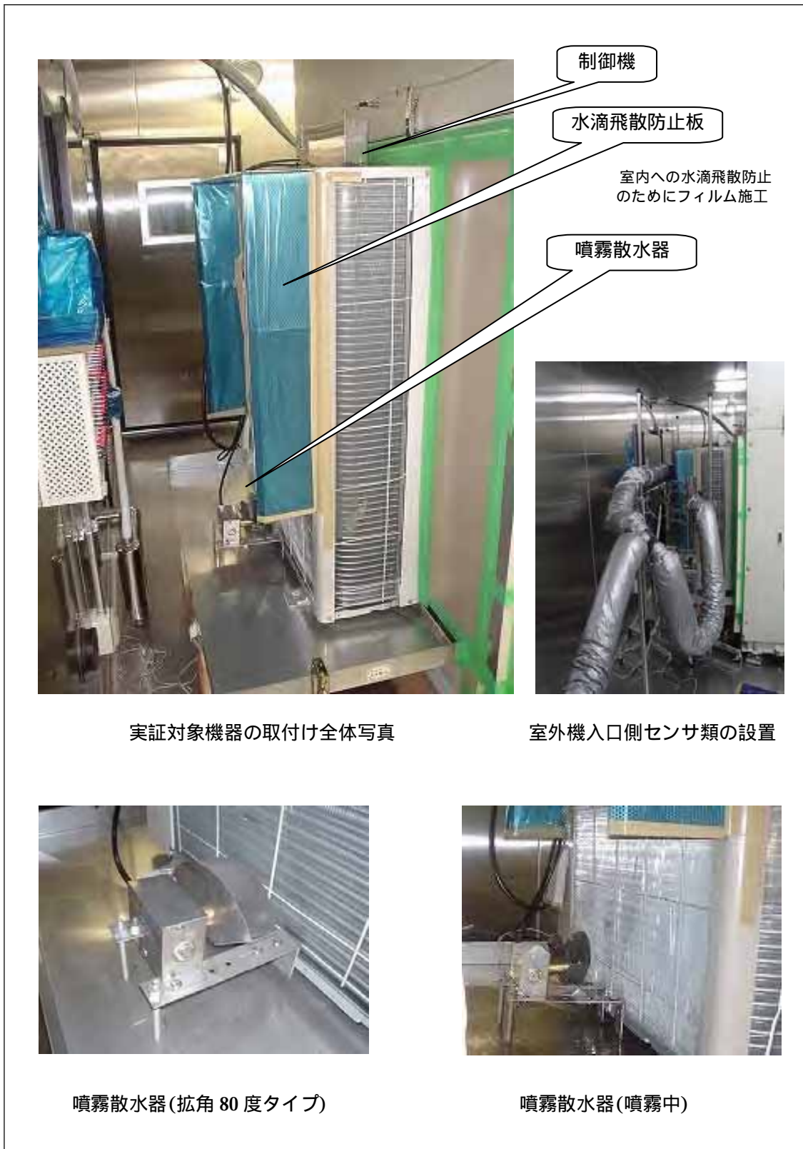
図 1 - 2 実証対象機器の設置状況
